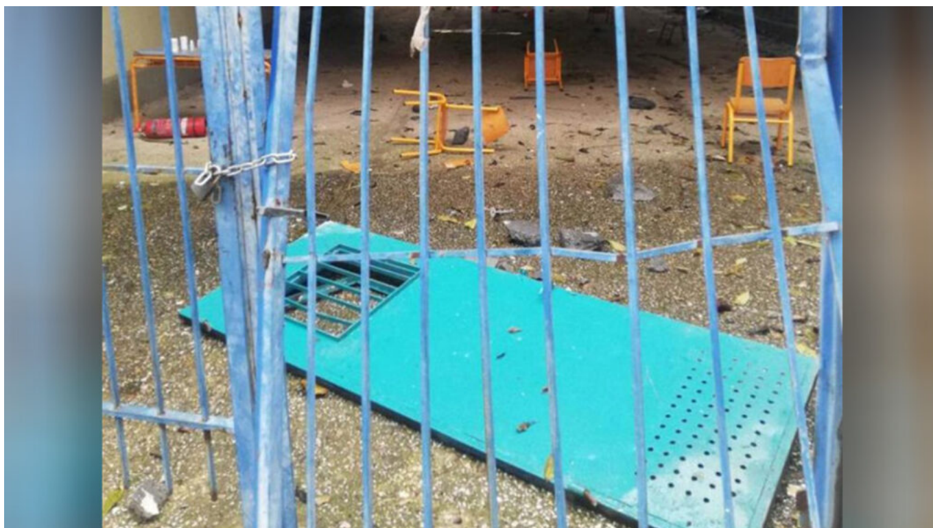
9ο Δημοτικό Σχολείο Σερρών – Η πόρτα του λεβητοστασίου
