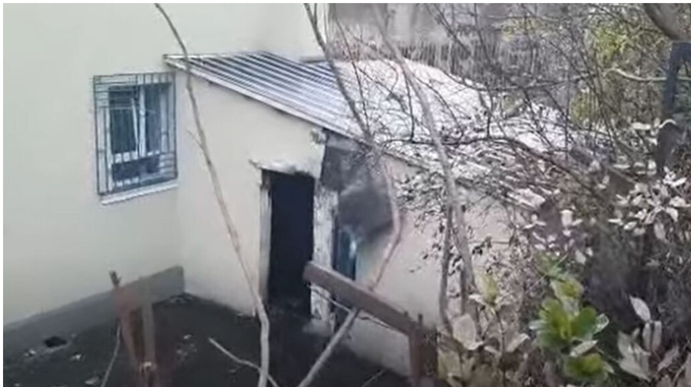
9ο Δημοτικό Σχολείο Σερρών – Το λεβητοστάσιο
